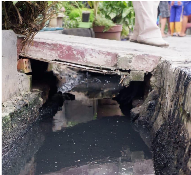
Gambar 1. Kondisi Drainase Kelurahan Plaju Ulu Sebelum Ada SERIKAYA
